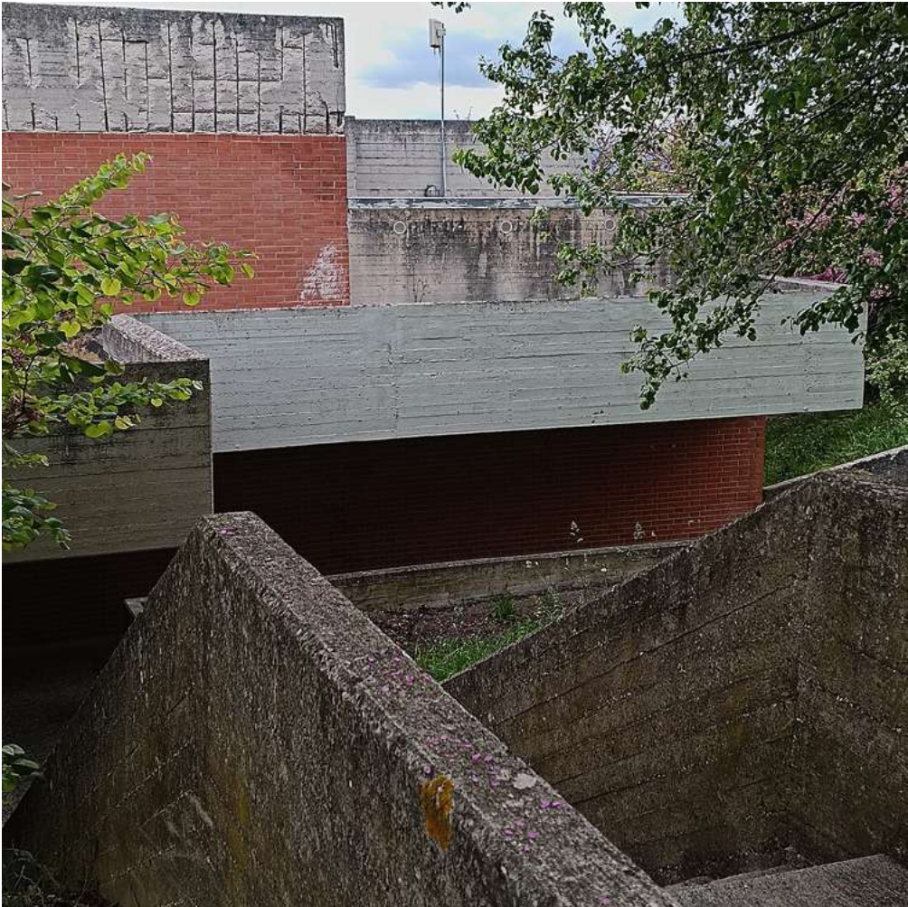
03. Collegio delle Serpentine. Fenomeni di deterioramento degli elementi costruttivi in c.a. e in mattoni faccia a vista. (Foto A. Cattaneo, 2024).
