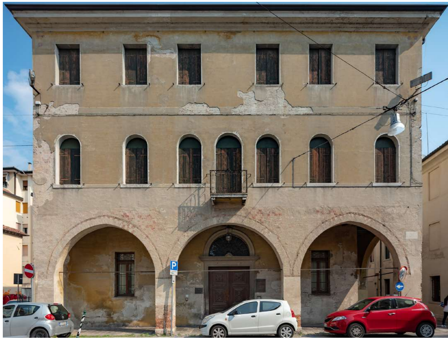
03. Facciata principale su Via San Niccolò pre-intervento | Main façade on Via San Niccolò pre-intervention state
