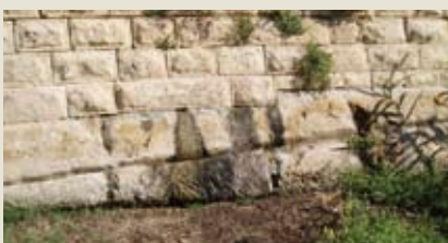
Malte sottoscavate e diffuso degrado biologico con relativo indebolimento della muratura
