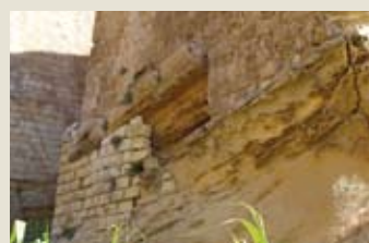
Banco biocalcarenitico disgregato disposto a franapoggio, interessato dall'acqua di risalita
