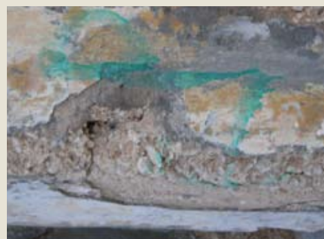
Macchia. Alterazione che si manifesta con pigmentazione accidentale e localizzata della superficie. È correlata alla presenza di materiale estraneo al substrato (ruggine, vernici, ecc.)
