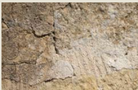
Scagliatura. Degradazione che si manifesta con il distacco totale o parziale di parti (scaglie). Le scaglie, costituite da materiale in apparenza inalterato, hanno forma irregolare e spessore consistente e disomogeneo
