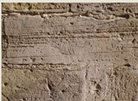
Erosione antropica. Rimozione di parti della superficie lapidea dovuta ad azioni antropiche e meccaniche. La superficie appare abrasa
