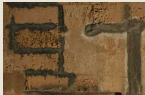
Integrazione cementizia. Integrazione incongrua di superfici o giunti con malta di natura cementizia
