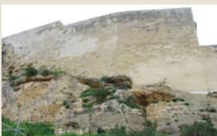
Fratture e diaclasi, parzialmente nascoste dalla vegetazione, che si sviluppano fino alla base della Cittadella
