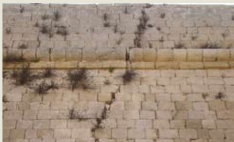
Fessurazioni. Degradazione che si manifesta con soluzioni di continuità nel materiale e che può implicare lo spostamento reciproco delle parti. Le lesioni, visibili sulla superficie della muratura, possono essere passanti
