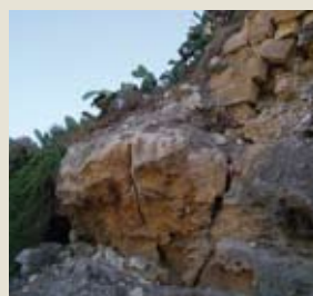
Fratturazione verticale con taglio del banco biocalcarenitico a burrow e crollo del muretto sovrastante
