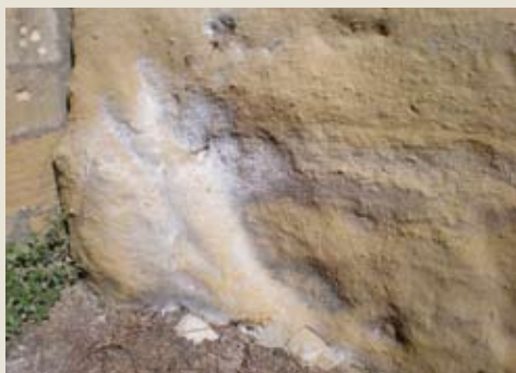
Efflorescenza. Formazione di sostanze, generalmente di colore biancastro e aspetto cristallino o pulverulento o filamentoso, sulla superficie del manufatto
