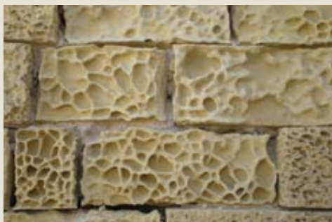
Alveolizzazione. Morfologia di degrado che si manifesta con la formazione di fori e cavità di diversa forma e dimensione, ma per lo più tondeggianti e in forma di alveoli spesso interconnessi tra loro
