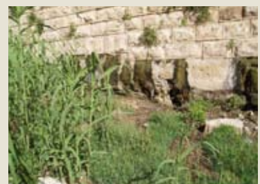
Acque di indefinita natura che scorgano tra le malte di allettamento della muratura ed il banco biocalcarenitico
