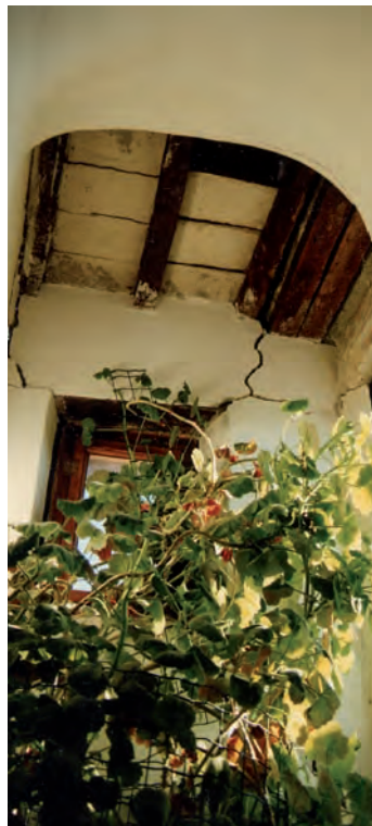
Porta Torre Medievale annessa al Palazzo Olivieri, particolare del torrino di accesso alla terrazza della Torre medesima, gravemente lesionato dal sisma
