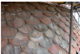
Degrado del manto di copertura della cupola
