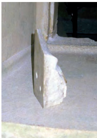
La parte di marmo distaccata è stata ricollocata tramite l'impiego di barre di acciaio inossidabile e resine
