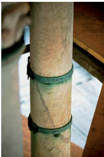
Sostituzione delle vecchie cerchiature in rame con altre in acciaio inossidabile, dopo la pulitura dei marmi
