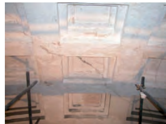
Rimozione dei vecchi interventi di restauro con malta cementizia. Impacco per la rimozione dell'umidità. Ricostruzione delle modanature con malta di calce
