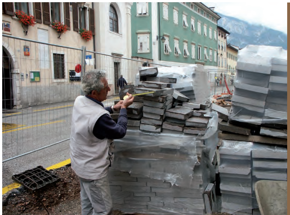
Comune di Lavis, controllo del materiale secondo il regolamento del marchio "Porfido Trentino Controllato"
