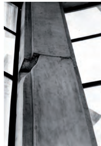
Distacco di un frammento di marmo dalla lanterna della cupola
