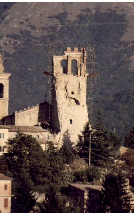
Nocera Umbra, Torre Civica detta "il Campanaccio". Lo stillicidio sismico del 26 settembre 1997 e dei giorni successivi causa il crollo delle pareti nord, sud ed ovest
