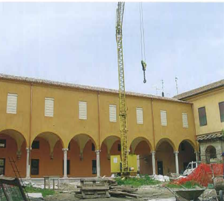
Il complesso architettonico è stato oggetto di un cantiere di restauro all'inizio del 2001
