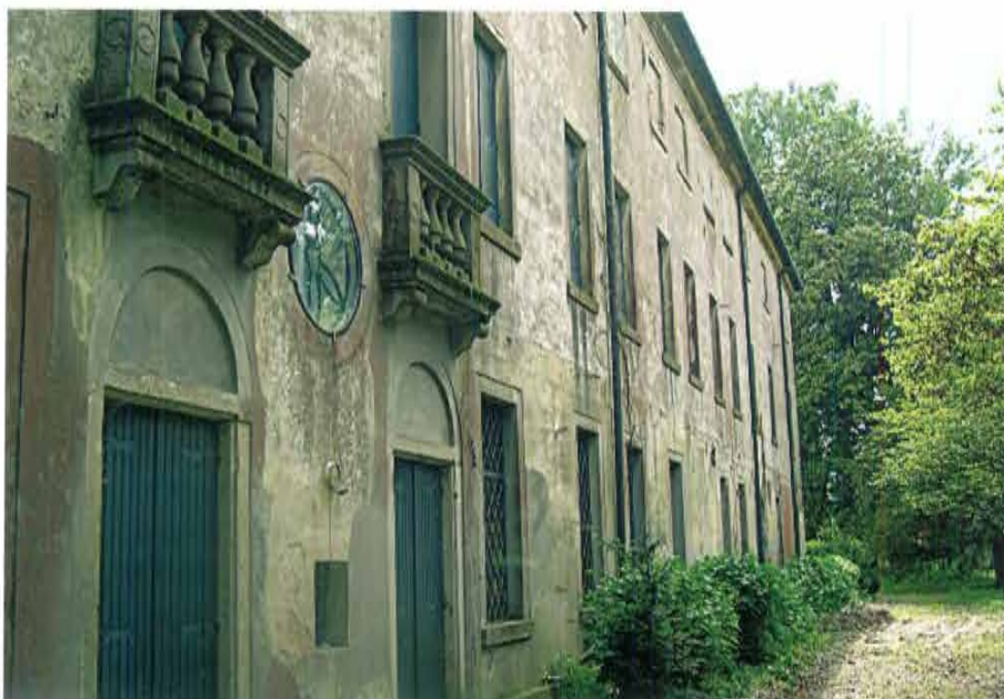
Scorcio del lato nord. Si nota il pregio architettonico della facciata e lo stato di conservazione delle finiture superficiali
