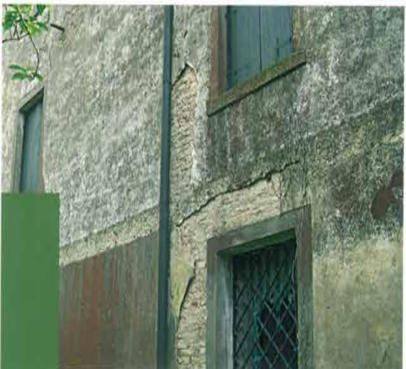
Dettaglio dello stato di conservazione delle finiture superficiali in un particolare della facciata nord dell'edificio
