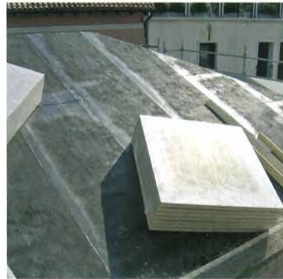
Pannelli class B Stiferite prima della posa sopra la barriera al vapore
