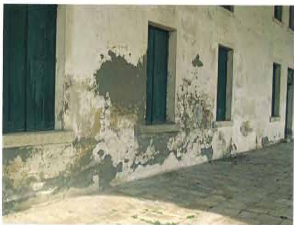
Degrado delle finiture superficiali della muratura retrostante il portico del lato sud in corrispondenza dell'attacco a terra dovuto alla risalita capillare dell'umidità
