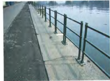
Interventi invasivi: scritte luminose, reti di impianti, pensiline e strutture metalliche, elementi di protezione fissati con tasselli nel blocco in pietra conformato per l'argine
