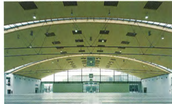
Copertura della nuova Fiera di Karlsruhe (Germania). Esempio per le infinite possibilità che offre il legno lamellare. Foto Hans Jürgen Landes
