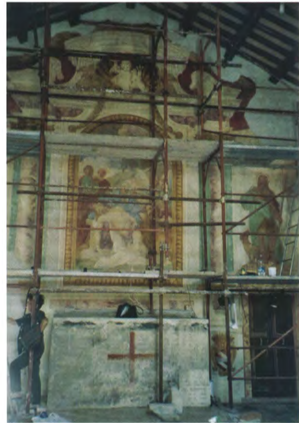
La parete dell'affresco durante i lavori. È visibile l'altare, ormai privo di caratteri stilistici
