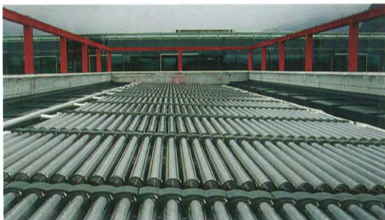
Sede EURAC a Bolzano. Sistema di captazione solare costituito da collettori con tubi a vuoto in copertura. L'impianto copre il fabbisogno di acqua calda sanitaria e funge, durante i periodi di mezza stagione, da riscaldamento di base. D'estate contribuisce con il termorefrigeratore ad assorbimento alla climatizzazione dell'edificio
