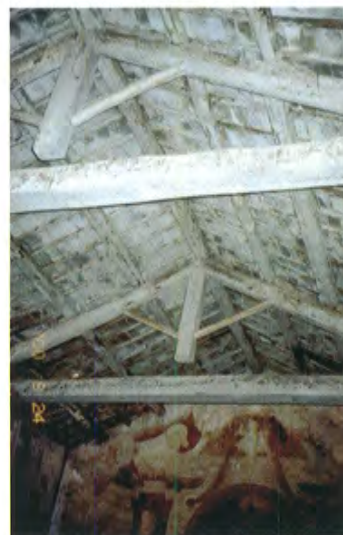
Il tetto prima del restauro, completamente dipinto di bianco
