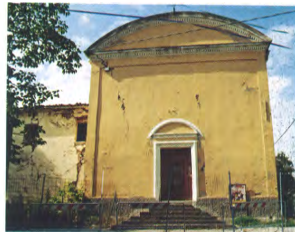
Vista del fronte della chiesa prima dell'inizio dei lavori di restauro. Nella canonica a sinistra il tetto è crollato ed è visibile una estesa lesione
