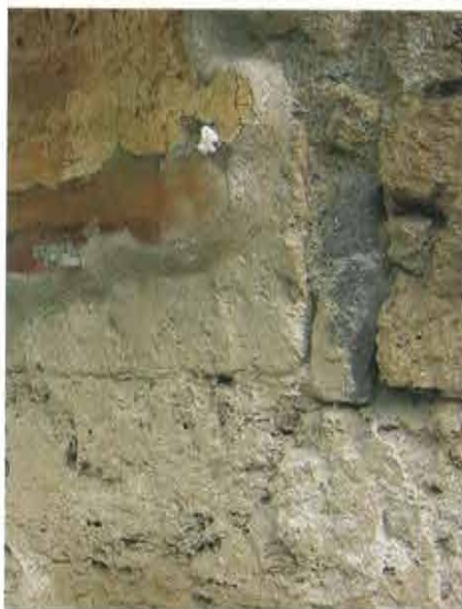
Particolare del paramento murario su cui sono state eseguite le stuccature con prodotti messi a punto dal centro ricerche Fassa Bortolo; sono visibili i degradi cui le murature delle botteghe sono soggetti, tra cui lacune, mancanze, integrazione con malte di probabile natura cementizia e zone fortemente degradate sottoposte a interventi di restauro nel secolo scorso
