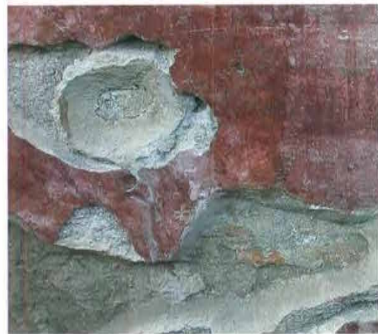
Particolare del frequente degrado che si riscontra negli intonaci dei fronti delle botteghe oggetto del cantiere di restauro a causa della forte presenza di umidità e degli interventi non idonei eseguiti in passato; i cordoli sui perimetri dei lacerti di intonaco, eseguiti durante interventi del secolo scorso con malte di probabile natura cementizia, hanno causato la perdita di materiale originale
