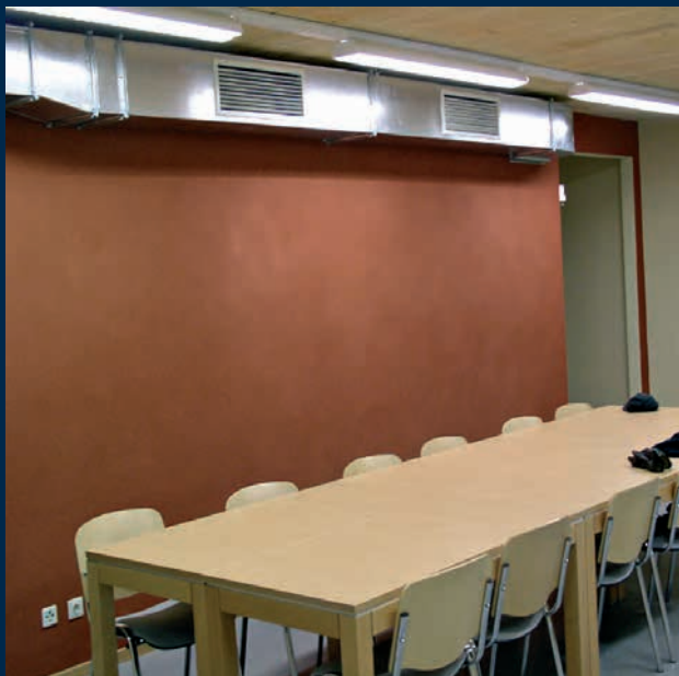
Veduta del foyer di ingresso con il sistema di ripartizione dell'aria a soffitto
