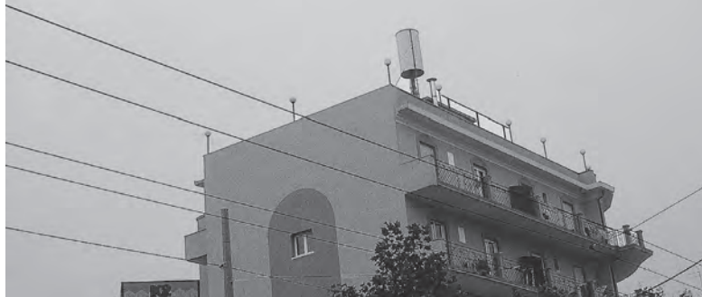
Antenne per la telefonia cellulare racchiuse all'interno di un contenitore metallico
