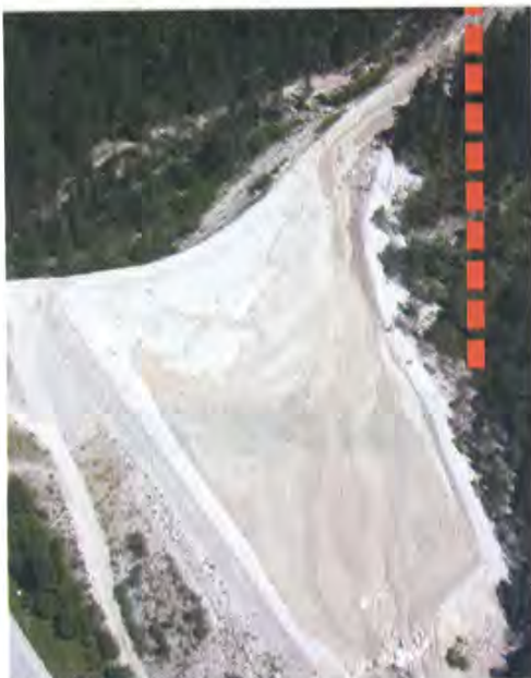
Bacino di deposito a protezione della SS Alemagna, dove è stata effettuato il test con lo scanner laser
