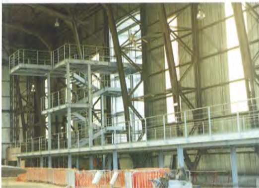
Vista d'insieme del ballatoio e del corpo scale. Il colore grigio chiaro verrà applicato su tutte le superfici interne dell'hangar restaurato
