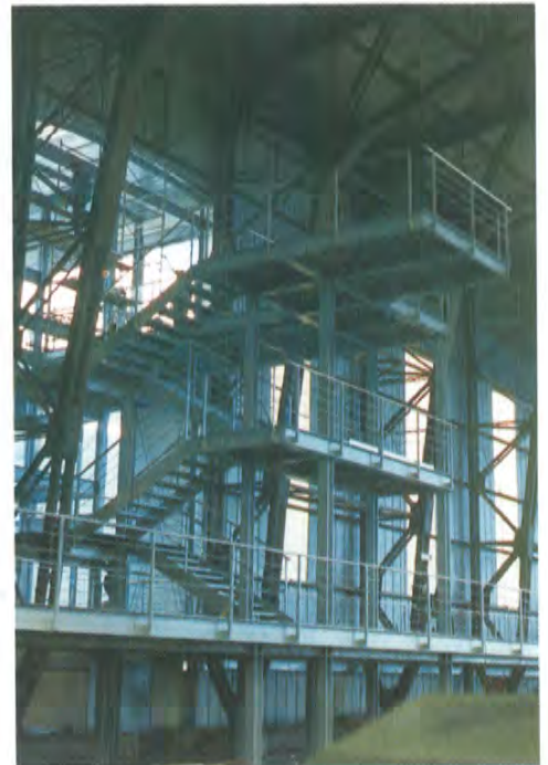
Il corpo scale e, sul retro, l'ascensore vetrato e il corpo di collegamento
