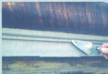
Particolare del timpano del fronte principale durante le opere di restauro della cornice
