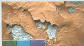
Esfoliazione. Degradazione che si manifesta con distacco, spesso seguito da caduta di uno o più strati superficiali subparalleli fra loro (sfoglie).
