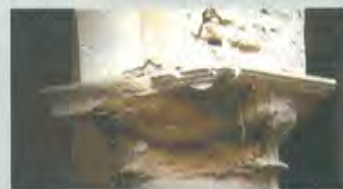
Distacco. Soluzione di continuità tra strati superficiali del materiale, sia tra loro che rispetto al substrato; prelude in genere alla caduta degli strati stessi.
