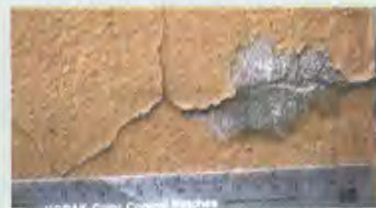
Fessurazione. Degradazione che si manifesta con la formazione di soluzioni di continuità nell'intonaco e/o nella pellicola pittorica e che può implicare lo spostamento reciproco delle parti.
