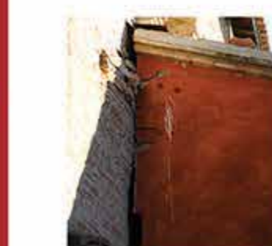
Casametta, corpo di fabbrica addossato alla cortina muraria nell'angolo nord-est della corte interna. I danni più significativi in corrispondenza dell'annosatura alla cortina muraria: profonde lesioni verticali agli angoli, che si allargano progressivamente verso l'alto.
