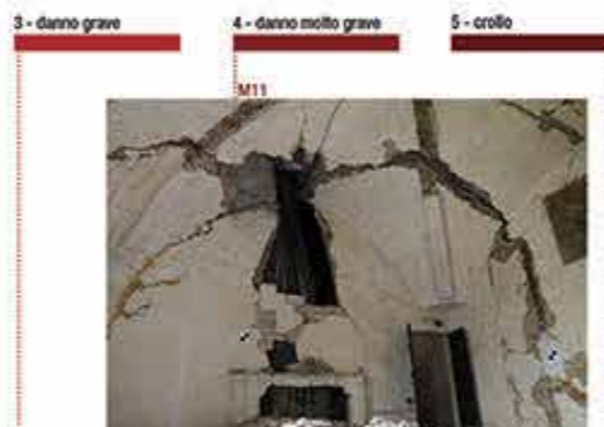
Mastio: stanza di Giulio II, ingenti crolli del soffitto voltato, in corrispondenza delle diagonali e vicino alla parete che ospita al suo interno la canna fumaria.
