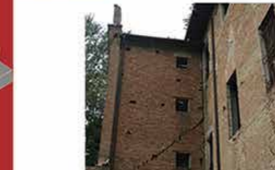
Non adeguato ammassamento tra i due corpi di fabbrica annessi in fasi successive. La mancata coesione ha comportato fenomeni di martellamento tra le due strutture.
