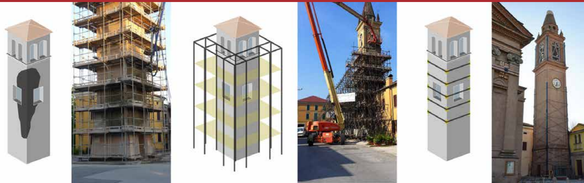
Patrimonio culturale danneggiato dal sisma: prime opere di messa in sicurezza
