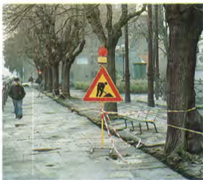
Scavo delimitato unicamente da dissuasori visivi
