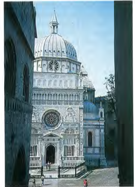
Bergamo, Cappella Colleoni (ultimo quarto del XV sec.), veduta esterna. L'immagine mostra gli esiti d'una radicale pulitura che ha ottenuto l'effetto di ottundere ogni ombra e rilievo, lasciando quasi prevalere sulla forma architettonica e sulla stessa decorazione il valore 'mineralogico' della pietra in sé. Non si vuole qui affatto negare la legittimità dell'intervento né l'opportunità di effettuarlo per rimuovere possibili cause e focolai d'ulteriore degrado, ma soltanto rammentare il sempre valido criterio del 'minimo intervento', la necessità di commisurararlo alle reali necessità conservative e quella di non intaccare, per quanto possibile, la materia antica. Più che di pulitura sembra trattarsi d'una 'sterilizzazione' della pietra (foto G. Miarelli Mariani).
