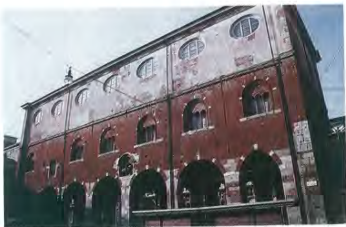
Milano, Palazzo della Ragione, prospetto principale (XIII e XVIII sec.), dopo il restauro. L'intervento ha rispettato ogni traccia del tempo e della storia sedimentatasi su questa facciata, segnata, in alto, dall'aggiunta settecentesca. Qui s'è soltanto consolidato l'esistente, rifiutando anche il più modesto rappizzo d'intonaco. È una delle primissime applicazioni ed un cosciente paradigma della 'pura conservazione'. Inoltre il monumento restaurato, accanto alla pienezza documentaria, ha mantenuto inalterate la sua carica evocativa ed estetica (foto G. Stolfi).
