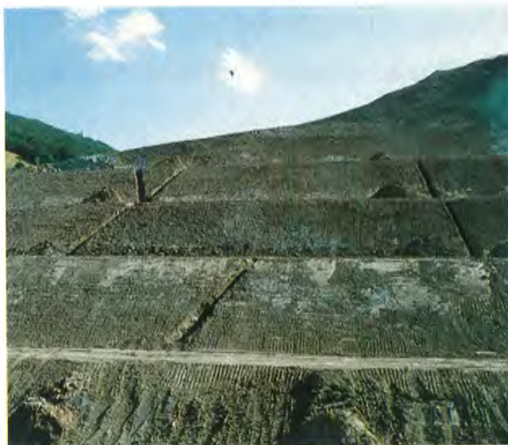
Assetto dei gradoni anteriormente alla posa dei teli con scavo dei drenaggi di sottotelo
