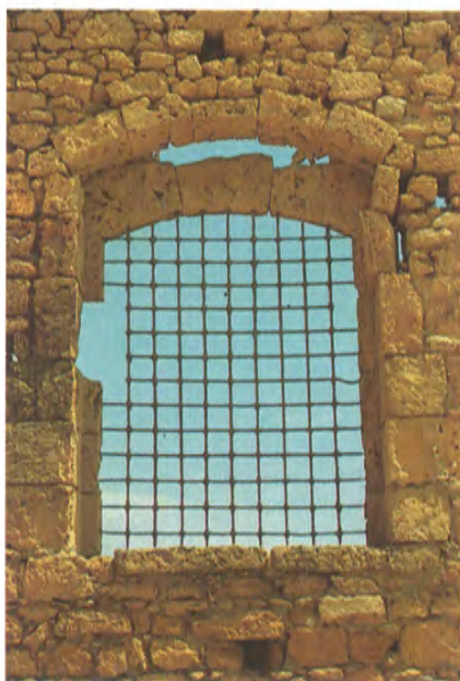
Avola, particolare della loggia, fronte Nord; finestra a sesto ribassato, con profilo di conci di pietra calcarea ed inferriate incastrate che non presentano saldature.
