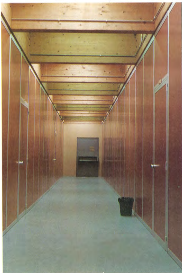
Adeguamento alle norme antincendio in un edificio ad uso uffici. Per creare nuovi spazi sono state impiegate pareti mobili, dotate di porte con senso di apertura verso l'interno.
