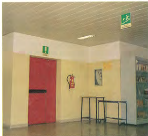
Adeguamento alle norme antincendio in una scuola. Si possono notare le indicazioni di sicurezza, la presenza dell'estintore e della cassetta contenente lancia e manichetta incassata nel muro. Un semplice accorgimento: la porta per l'uscita di sicurezza (con maniglione antipanco) dipinta di rosso, trasforma una prescrizione obbligatoria in un elemento architettonico di risalto.
